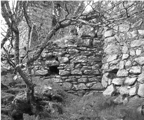
Fig. 6. Detalle del ábside (posible atalaya) y unión con el muro de la “capilla o sacristía”. (Imagen: DGP)
